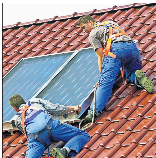
Solarthermieanlagen nutzen das Sonnenlicht, um Wärme zu erzeugen.
